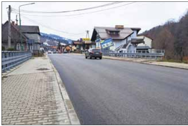
Część prac, związanych z wyciekaniem od lat modernizacją drogi wojewódzkiej przebiegającej przez centrum Szczyrku, została wykonana.
