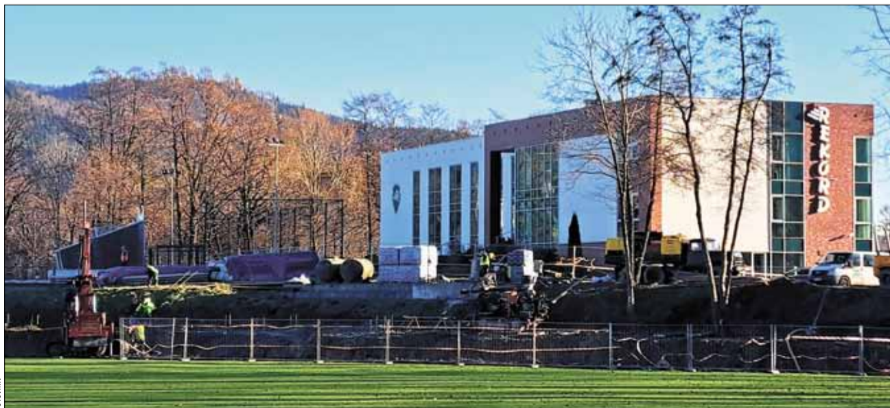
Na terenie kompleksu sportowego przy ulicy Startowej w Cygańskim Lesie rozpoczęła się budowa trybuny, co jest jednym z elementów inwestycyjnych planów Rekordu.
