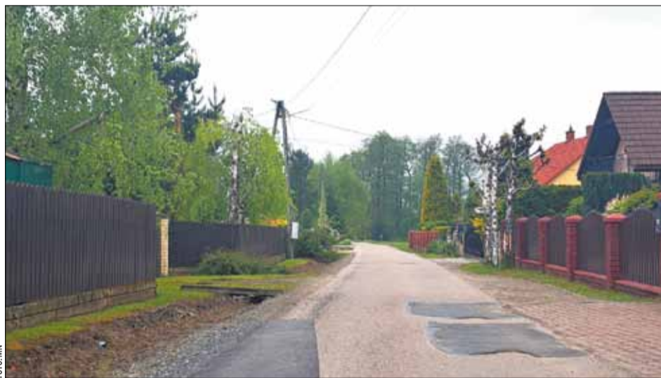
Na kilkunastu ulicach Jaworza prowadzone były w ostatnich tygodniach prace, które pozwoliły na uzupełnienie ubytków w nawierzchniach drogowych po okresie zimowym.
