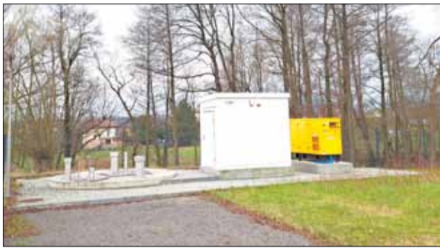
Oczyszczalnia ścieków w Huciskach wybudowana została w ramach realizacji wielomilionowego projektu kanalizacyjnego, stanowiącego znaczący krok rozwojowy dla Gminy Wilkowice.
