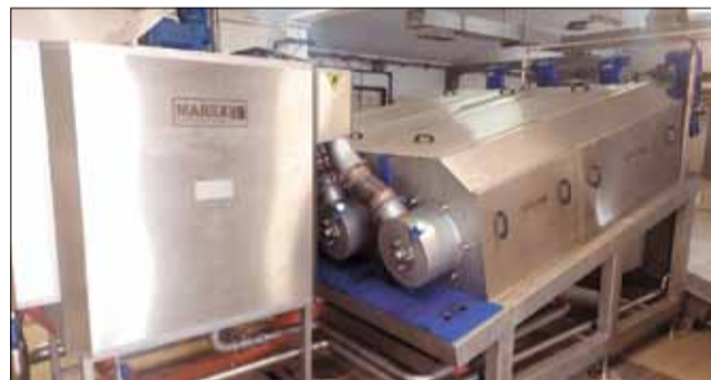
Prasa do odwadniania osadu ściekowego.
