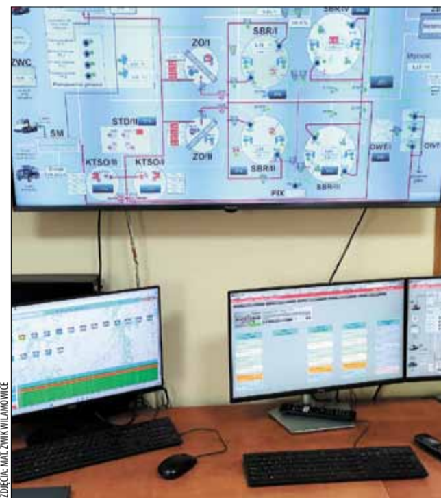
Stanowisko sterowania procesem oczyszczania ścieków.
