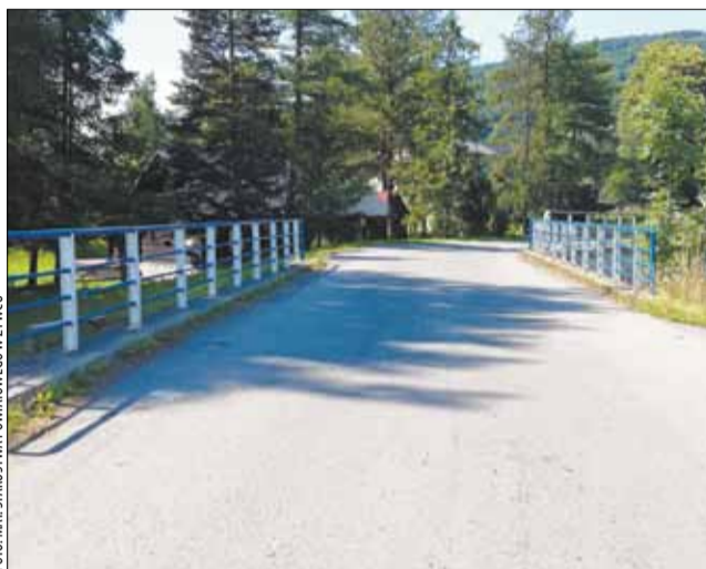
Most w Rycerze Górnej zostanie w tym roku przebudowany, obok niego powstanie kładka dla pieszych.
