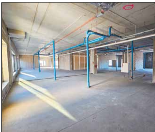
Oficjalne przekazanie placu budowy pod adaptację trzeciego piętra w Szpitalu Żywiec nastąpiło 24 stycznia tego roku, tuż po ruszeniu pierwszych prac.
