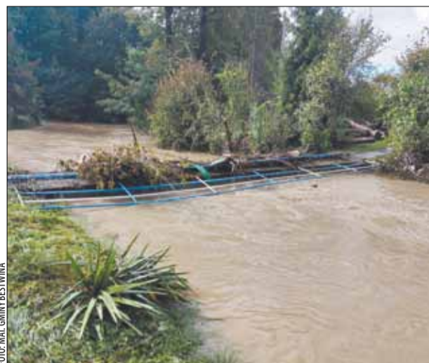
Jedna z kładek zniszczonych w czasie wrześniowej powodzi.
