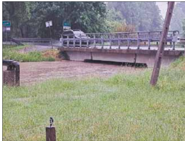
Zniszczone przez powódź mosty przy ul. Zabrzskiej...
